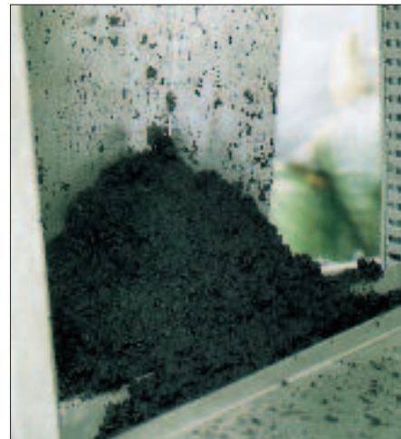
Fango in uscita dal preaddensatore Sludge leaving the pre-thickener
